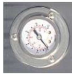
Contrôle de la pression sur le manomètre.
